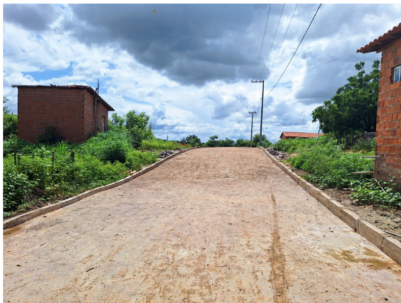
Figura 49 – Realização de obras de pavimentação e abastecimento de água em Santa Cruz dos Milagres.
